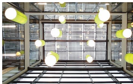
Fot. 5 Świetlik fotowoltaiczny
