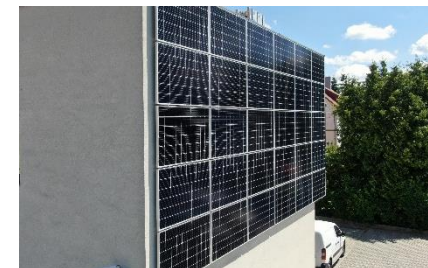
Fot. 19 Instalacja PV na fasadzie budynku
