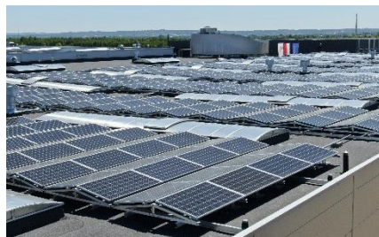
Fot. 18 Instalacja PV na dachu przedsiębiorstwa
