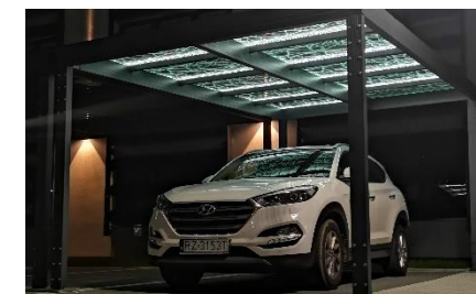
Fot. 12 Fotowoltaiczny carport
