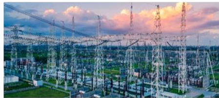
Tauron Dystrybucja. Modernizacja stacji elektroenergetycznej 110/15 kV Dworzowice. Wartość 25 mln PLN
