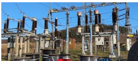
Tauron Dystrybucja. Modernizacja stacji elektroenergetycznej 110/20 kV Marciszów. Wartość 25 mln PLN
