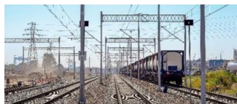
PGE Energetyka Kolejowa. Budowa podstacji trakcyjnej PT Kościerzyna. Wartość 16 mln PLN
