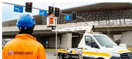
Zarząd Dróg i Utrzymania Miasta. Konserwacja sygnalizacji świetlnej we Wrocławiu 2024-2025. Wartość 17 mln PLN
